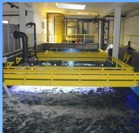
Locali tecnici dell'Acquario di Cala Gonone
